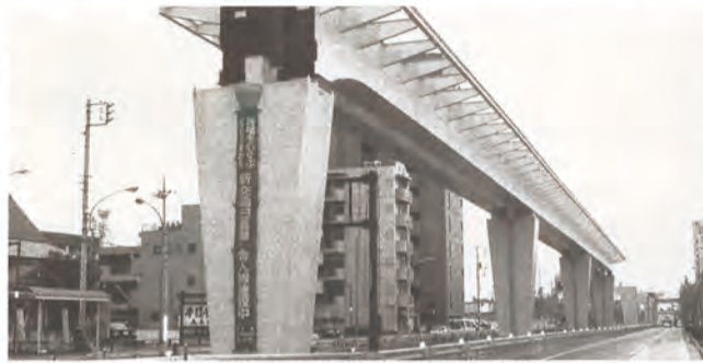
1日も早い開業が望まれます。 日暮里・舎人線建設現場(扇二丁目)
